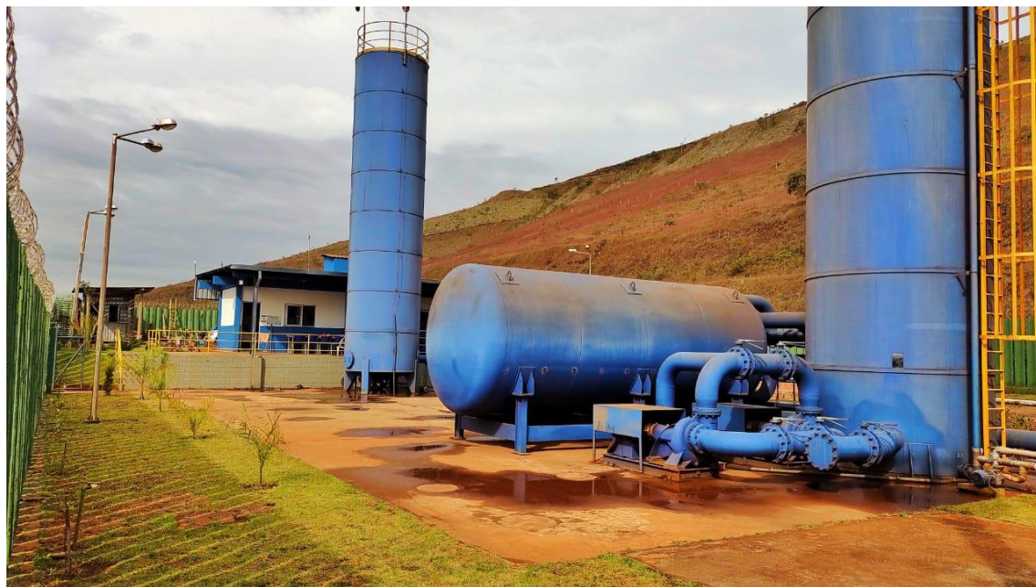
Sistema 01 - local de instalação do equipamento na UTA DI 040 - coordenadas: 20°14'11.54"S e 43°58'07.38"O
